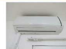
エアコン設置済み
